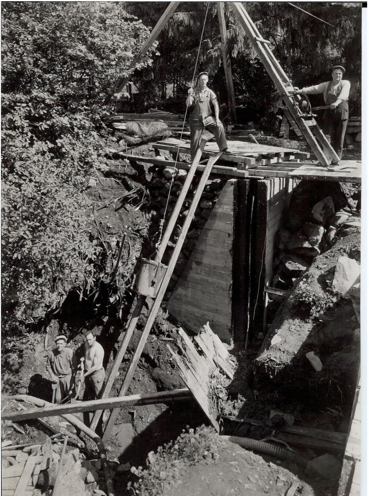
I 1946 ble demningen fornyet og broen over damkronen rehabilitert. Vi ser folk fra entreprenøren Astrup & Aubert A/S i arbeid med støpning. Kilde: Østensjø lokalhistoriske bilder, bilde-nr. B20100095.
